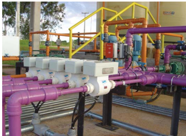
Aplicação do VMS® em linha de dosagem de produtos químicos em ETE da Caesb
